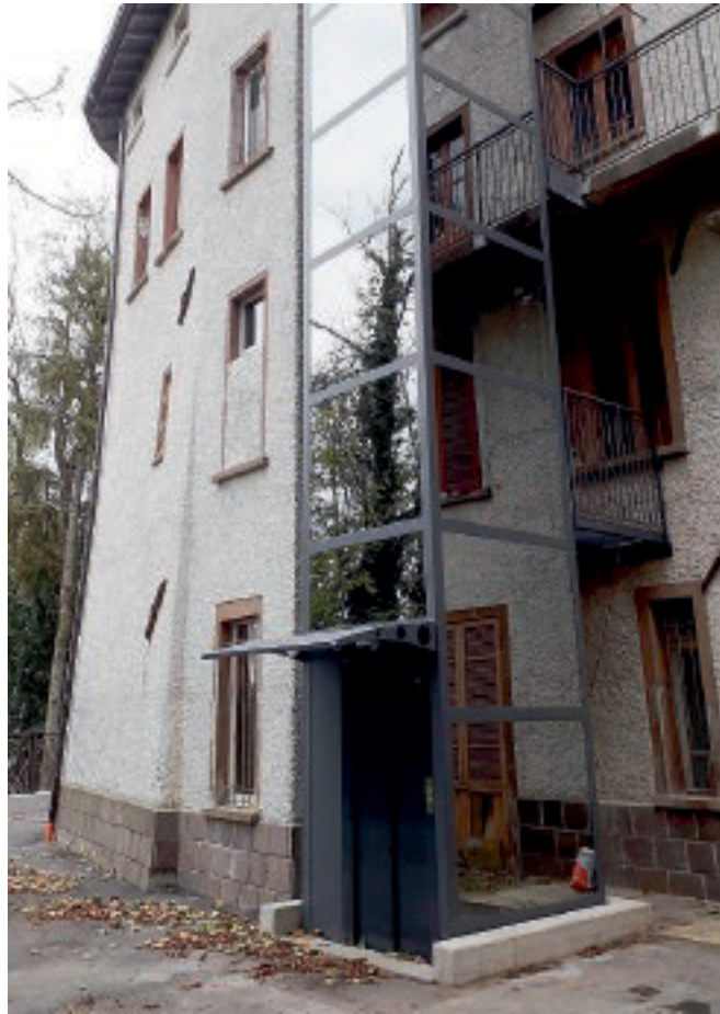
PIU' SICUREZZA L'ascensore del municipio.
